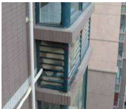
Exempel: Dålig luftcirkulation på utedelen
