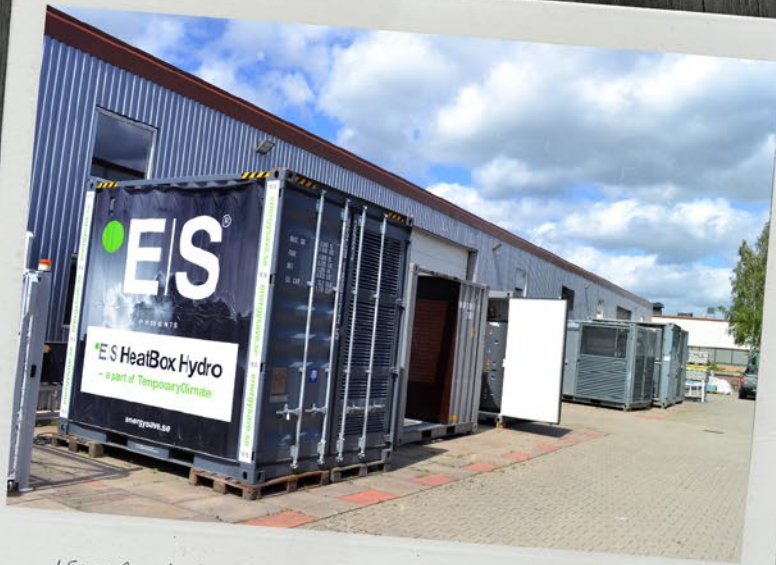
I Energy Saves lokaler i Alingsås pågår versionsutveckling av Plug-in-Modulerna. Här syns ett flertal olika moduler som snart är redo för leverans.
