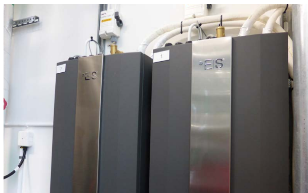
Värmepumpsinstallationer på HSB Living Lab.
